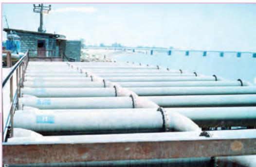
◆ پمپ‌های شناور کانال سلمان
